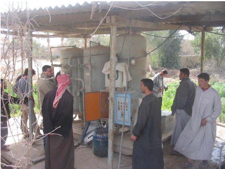
Irak : poste de contrôle et cuves de filtrage avant réhabilitation
